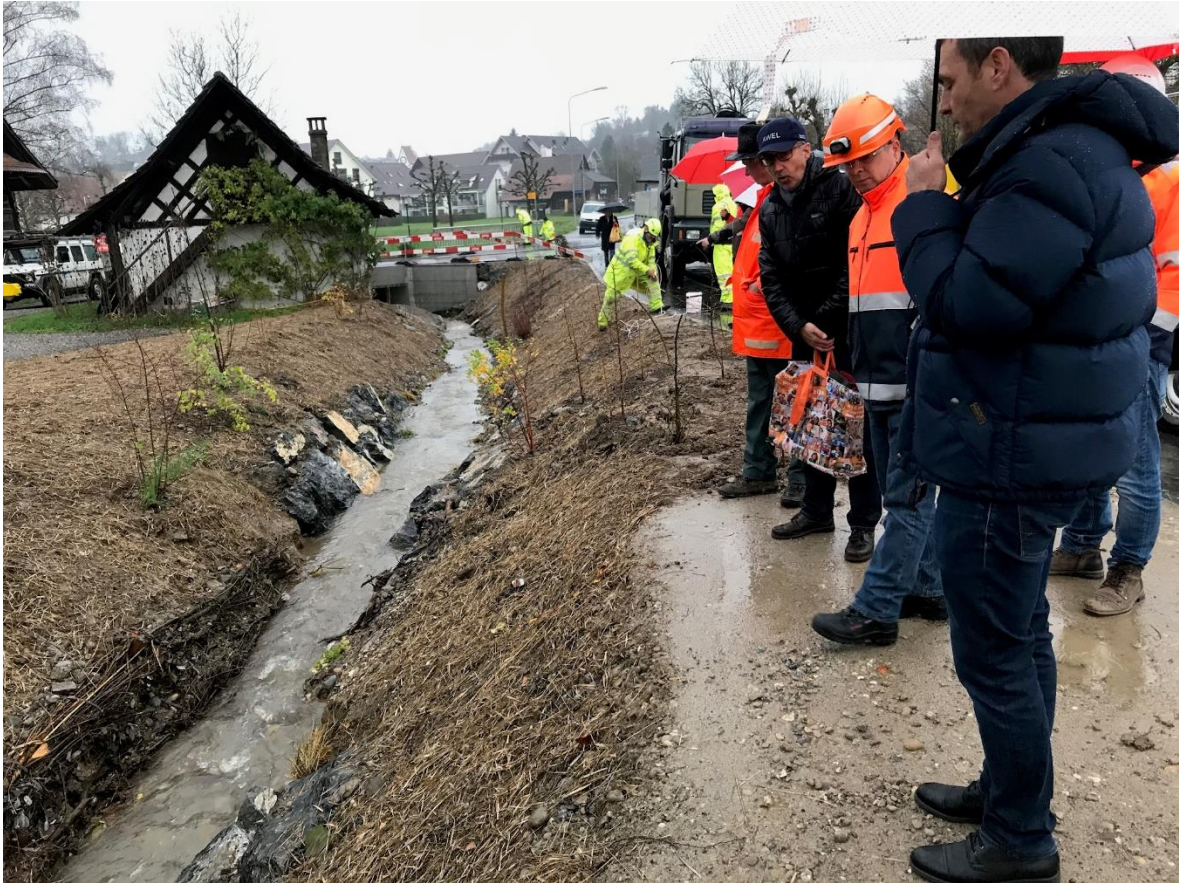
Bildlegende: Inspektion und erfolgreiche Abnahme durch das AWEL Ende November 2019.
